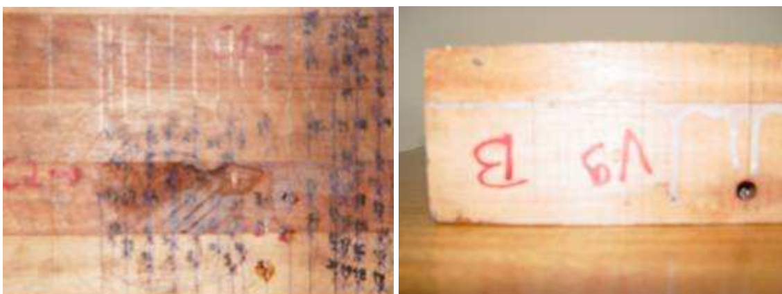
FIGURA 4.10 – Defeitos encontrados na inspeção visual.
